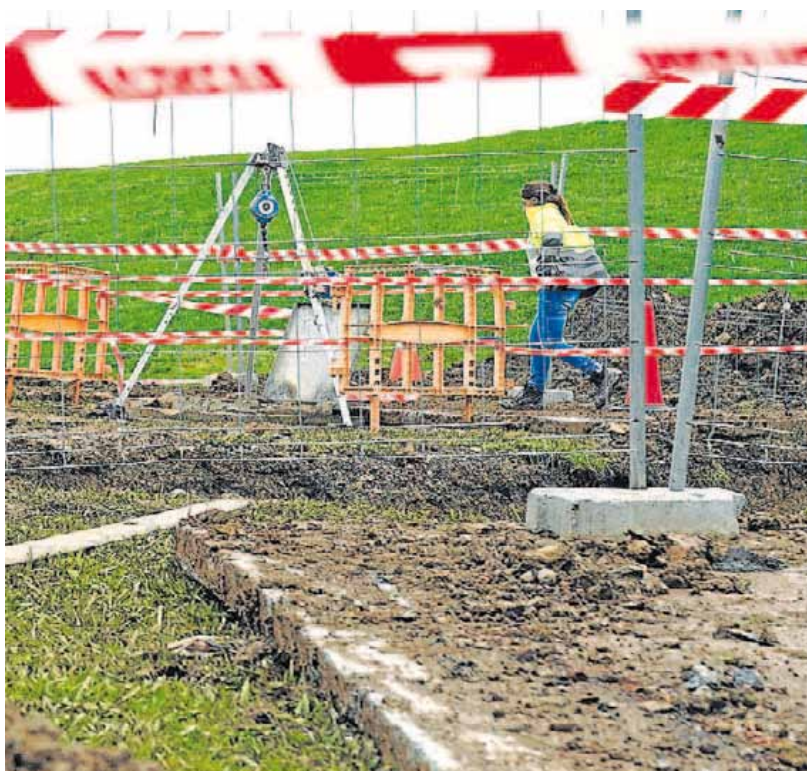
Zona de Erandio en la que reventó una tubería de abastecimiento de agua el pasado sábado. MANU CECILIO
