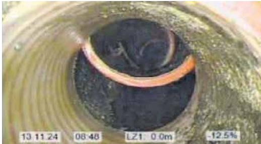
Uno de los tubos que conecta las pluviales de la PO-315. | FdV
